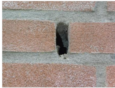
Figuur 4.29 Detailfoto van de open stootvoeg bij het clubhuis van Sportclub Westervoort (gebouwcluster 1).
