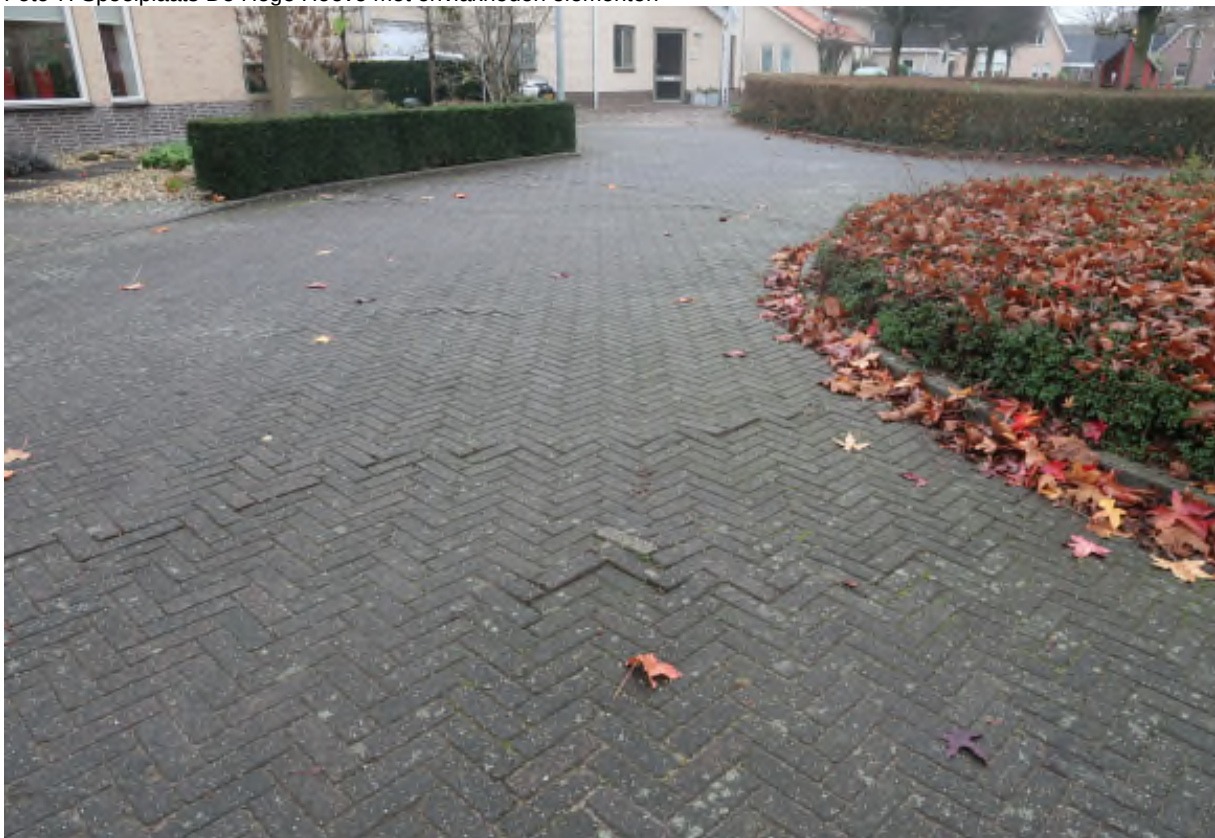
Foto 8: Wortelopdruk door nog niet volgroeide Kastanjeboom; schade komt terug bij niet aanpakken groeizone
