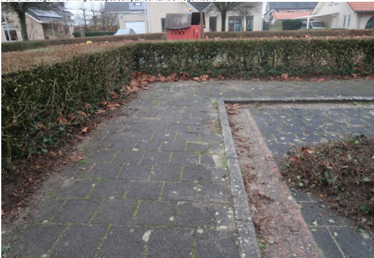
Foto 6: Parkeervak ter hoogste van speelplaats De Hoge Hoeve (onvlak voetpad; struikelgevaar)
