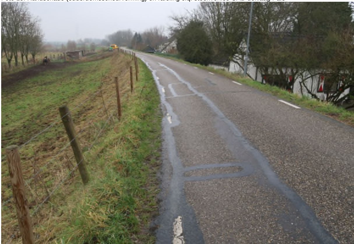
Foto 16: Gevulde scheuren Rijndijk met randschade
