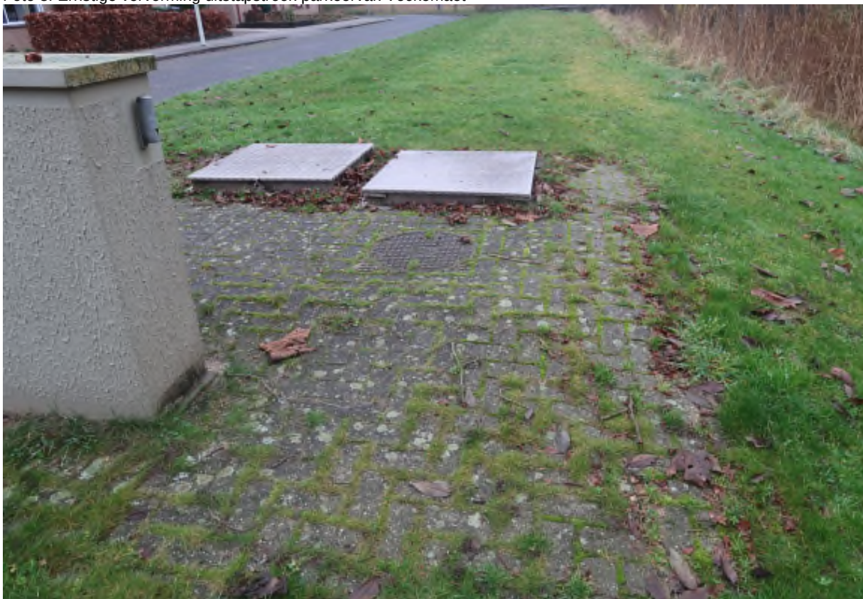
Foto 4: Vervormingen en verwaarlozing verharding 'j Jufferblock
