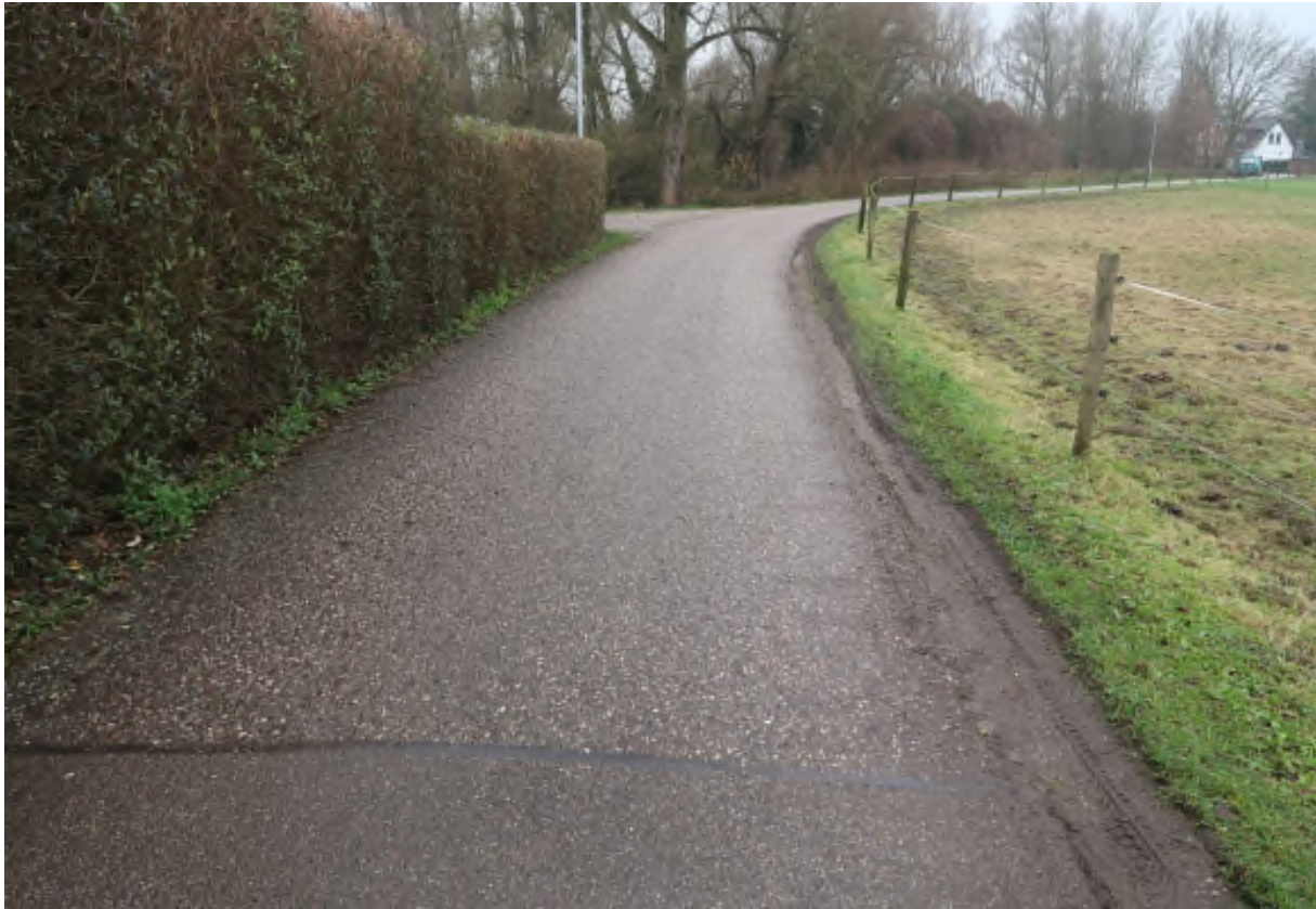
Foto 15: Randschade (ouderdomsscheurvorming) en rafeling c.q. steenverlies GAB-deklaag Pals
